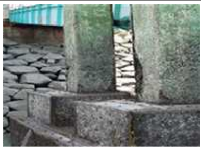
연안2잔교 조절탑 콘크리트 단면파손
